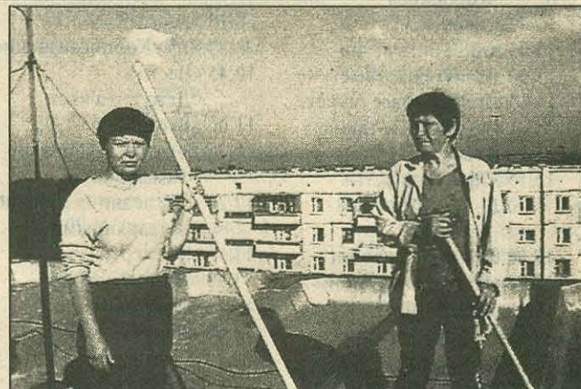
Штукатуры Раиса Хайбулина и ее дочь Оксана Барановская пришли в ЗАО «Теплосиб» в мае этого года. Их основной работой стал ремонт подъездов, штукатурка и побелка. А также покраска «малых форм» во дворах и ремонт щитовых. Совсем недавно эти женщины завершили работы по капитальному ремонту крыши дома № 77/3 по улице Космонавтов. Сейчас начал ремонт крыши 92-го дома, а в перечне работ у штукатуров появилась еще одна - по вечерам Раиса и Оксана занимаются ремонтом швов на нижних этажах дома № 88 по улице Космонавтов.
