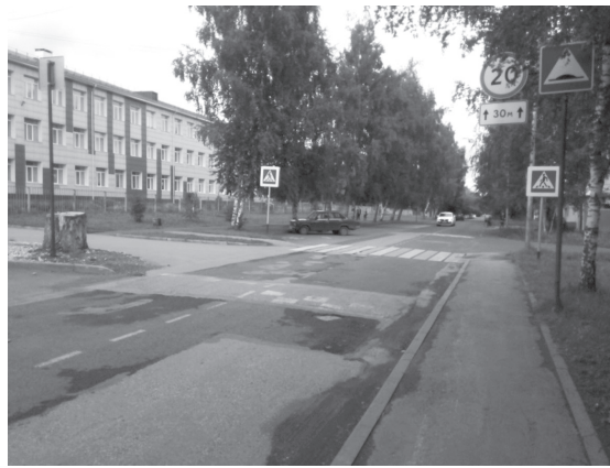
Рисунок 11 – Состояние дорожного покрытия ул. Иркутская города Полысаево
